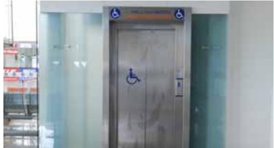
Sivas Nuri Demirağ Havalimanı Engelli Yolcu Asansörü
