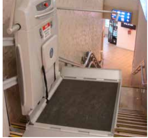
Atatürk Havalimanı İç Hatlar Engelli Lift Uygulaması
