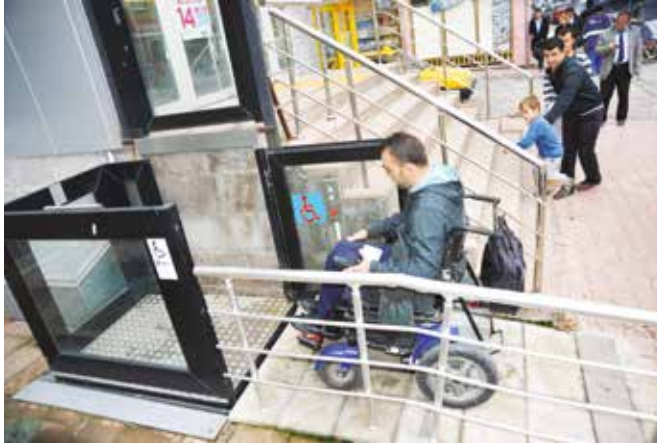
PTT Merkezi Engelli Yaya Rampası ve Yükselebilir Platform
